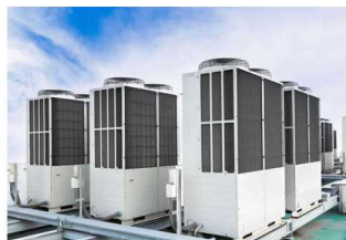
Отопление, вентиляция, кондиционирование
